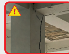
รอยร้าว ที่มุมเสาและคาน
