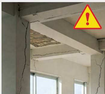
รอยแตกร้าว ที่มุมเสาและคาน
