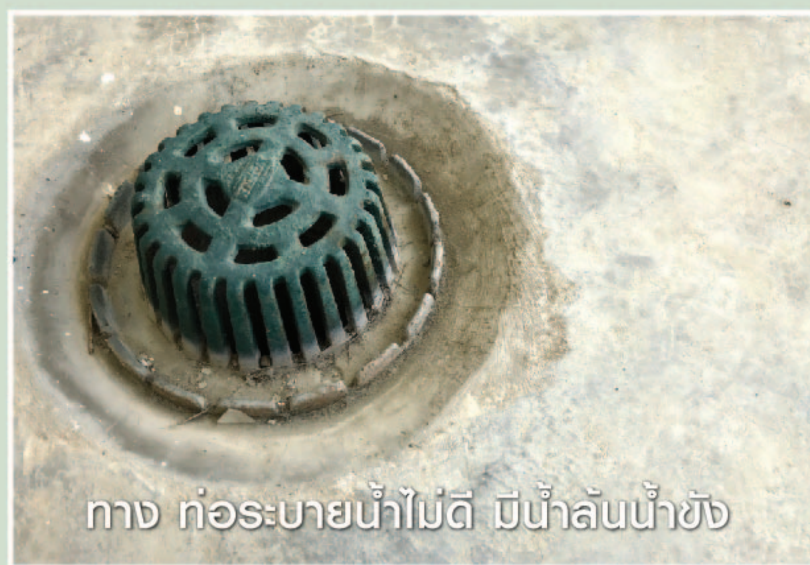
ดาดฟ้ามีรอยแตก มีหลุมแอ่งน้ำขัง
